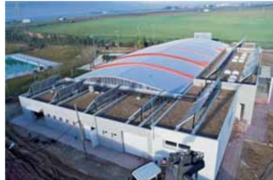
Captador de energía solar térmica (modelo Isotherm Plus) en el Polideportivo Municipal de Ugena, en Toledo. Se trata de una instalación de 176 m 2 .
